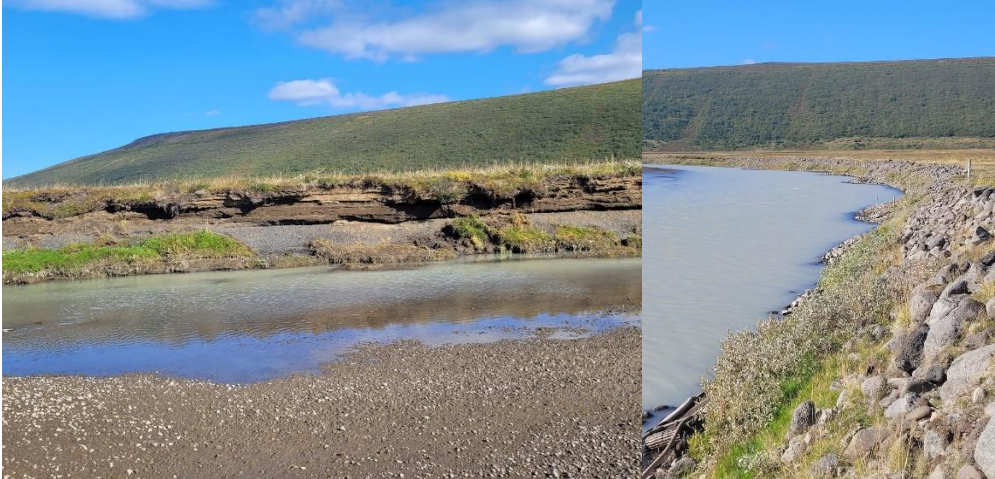
7. mynd. Austurbakki Skjálfandafljóts á fyrirhuguðu brúarstæði (vinstri mynd) og vörn gegn bakkabroti nokkur sem er þar nokkru neðar (hægri mynd).
